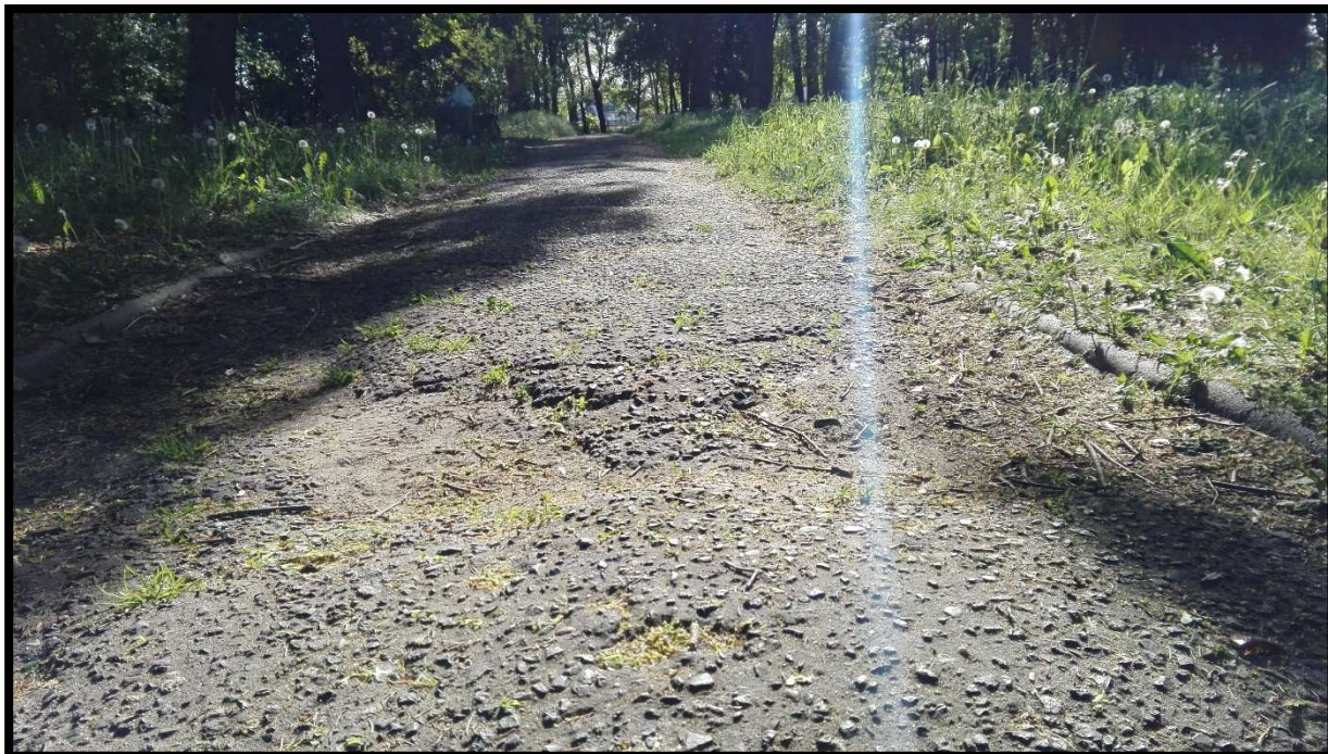
Zdjęcie nr. 7 Zły stan jedynej asfaltowej ścieżki w parku.
