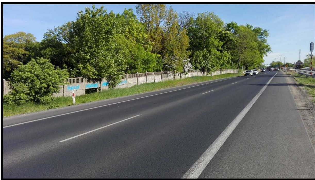
Zdjęcie nr. 2 Zdjęcie przedstawia szpecące i rozpadające się betonowe ogrodzenie przy wjeździe do wsi Łysomice z kierunku miasta Toruń.
