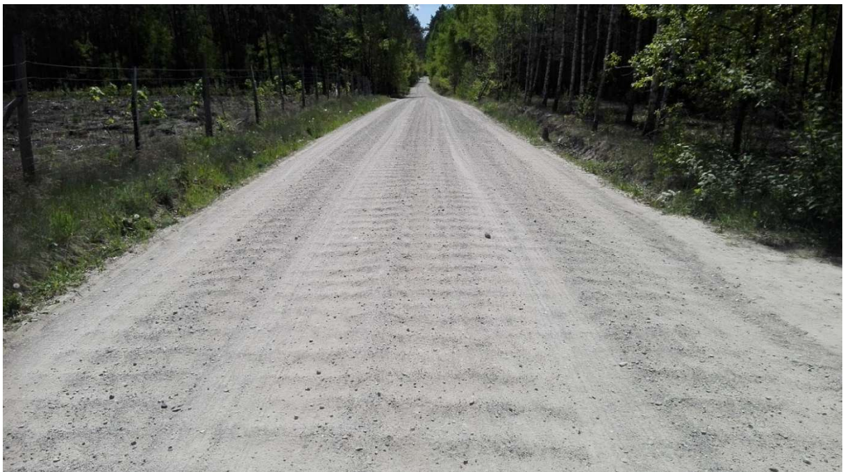
Zdjęcie nr. 2 Zły stan drogi (koleiny) ul. Kon-Tiki – Nadleśnictwo Toruń
